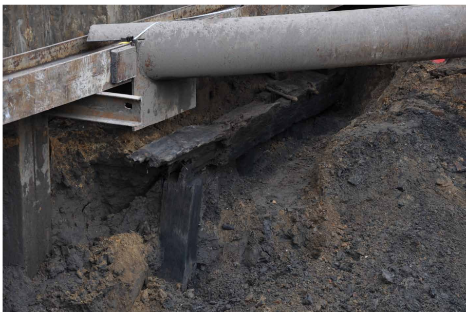
Afb. 3.5 Een deel van het brugjuk: staander F12 en ligger F11. Foto genomen richting het westen.
